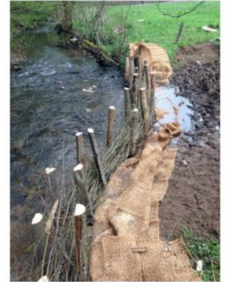
3 : Création d'un méandre, pose de la toile coco et pose des fascines de saules
