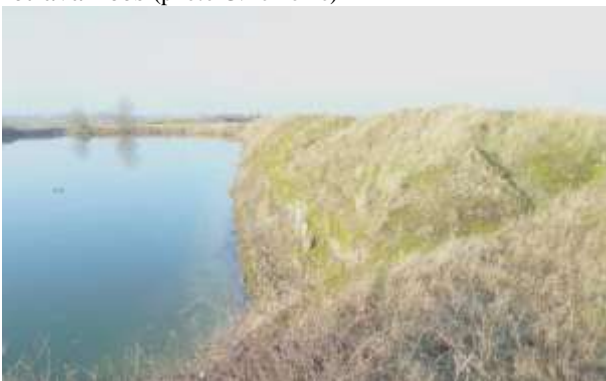
9 - État initial de la berge nord du petit étang (remblais de laitier) (photo G.Lemoine)
