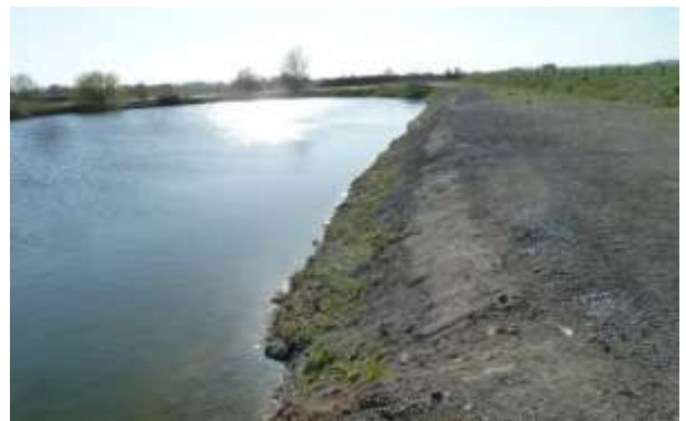
10 - Berge nord du petit étang après travaux d'évacuation du remblai (photo G.Lemoine)
