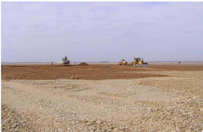
Épandage des différentes couches de sol au printemps 2011 (crédits : Solène Masson – IMBE)
