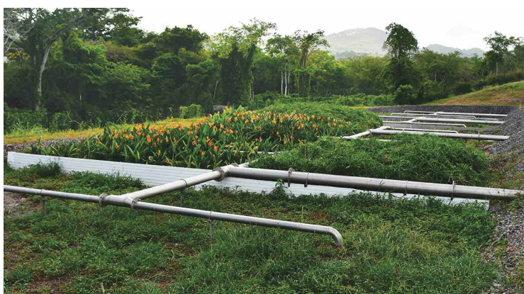
Figure 19. Exemple de partitionnement sur la station de Taupinière (Martinique). Au premier plan, le filtre est partitionné à l'aide d'ondulines. Une bride a été mise en place pour isoler les points d'alimentation desservant le demi-filtre qui n'est pas en service. À l'arrière-plan, les casiers qui forment la seconde file de la station ne sont pas en service et n'ont pas été plantés.
